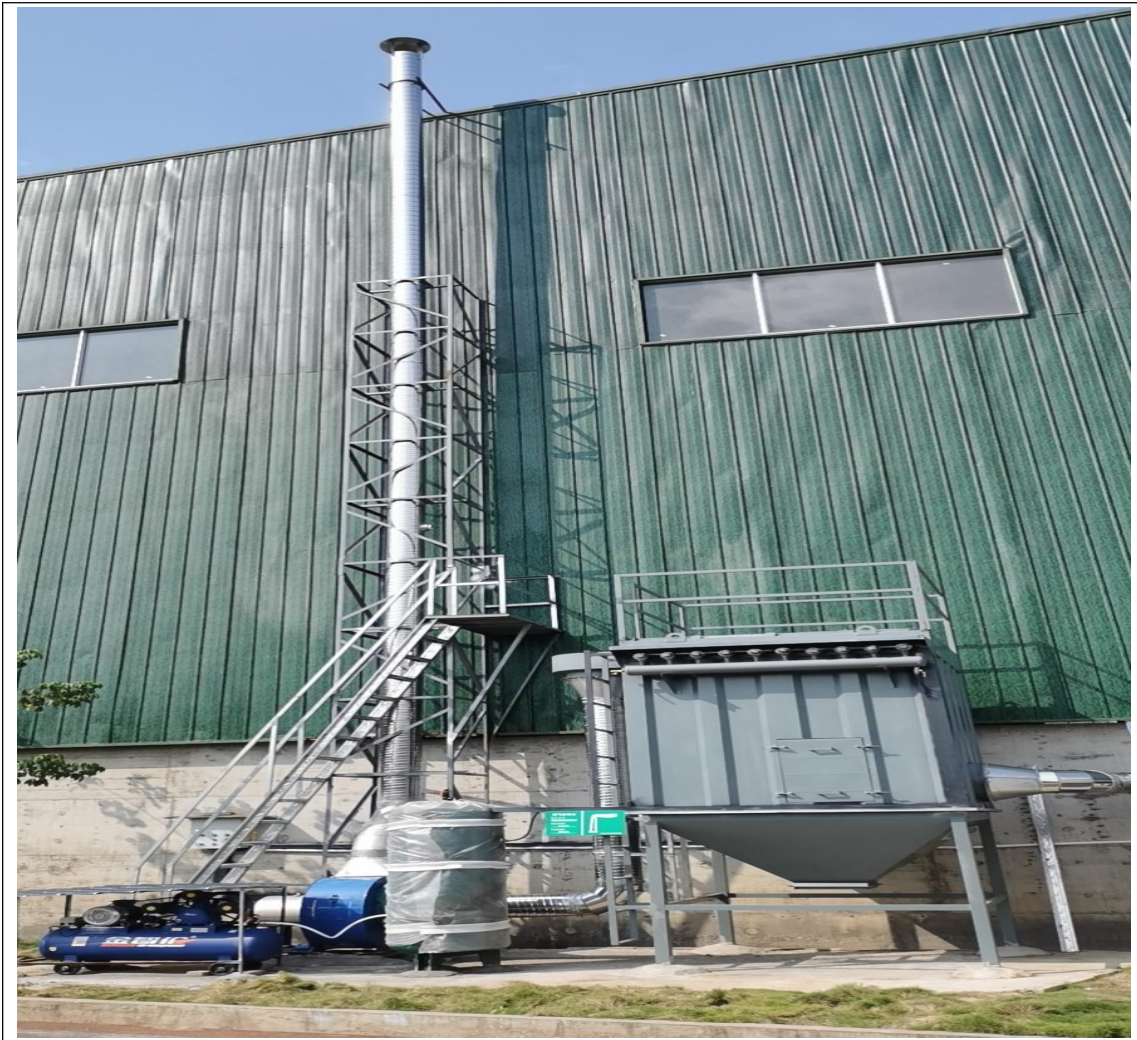
图 4-4 废气治理区照片
