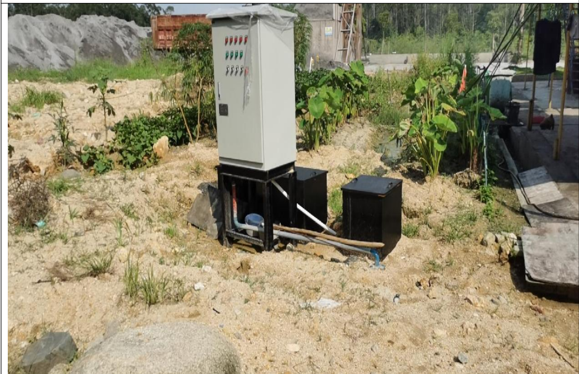
一体化污水处理设备
