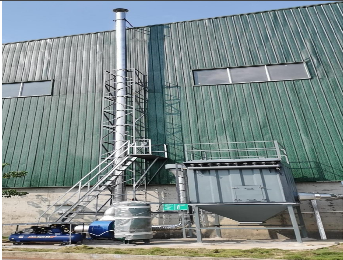
废气处理设施
